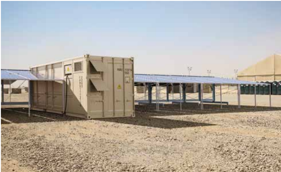
Streitkräfte können mit dem PV-Batteriespeichersystem entweder eine autarke Grundversorgung aufbauen oder das System in ein vorhandenes Versorgungsnetz integrieren
